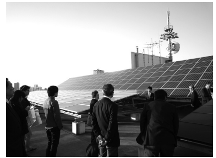
屋上に設置されたPVパネル
